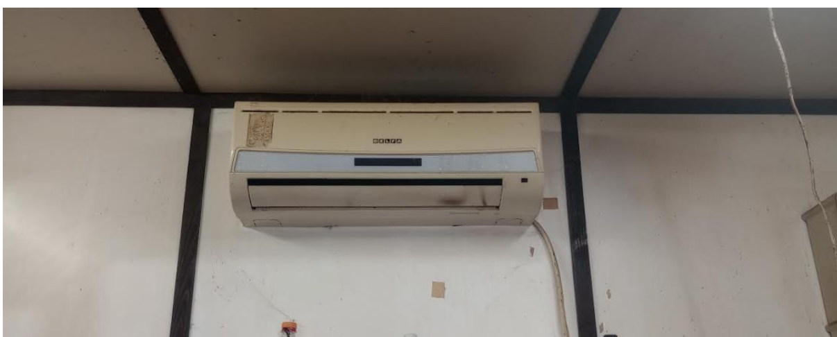
*Nainštalovaná vlastná klimatizácia
