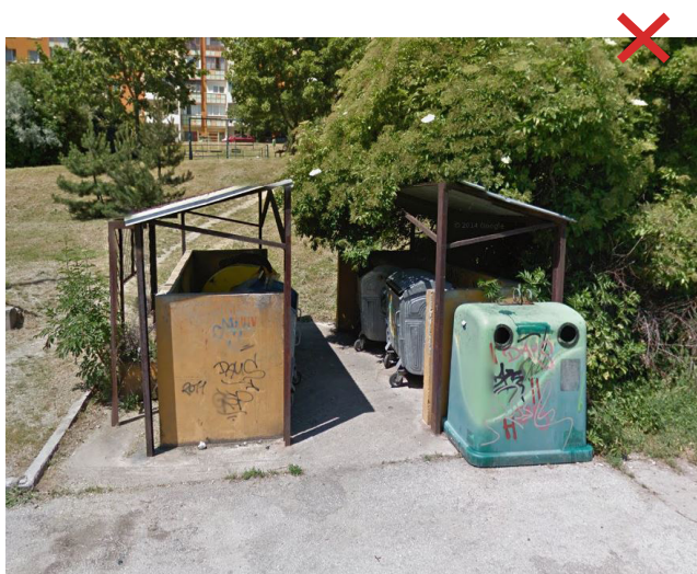
kontajnerové stanovište vyžadujúce rekonštrukciu Tománkova ulica
