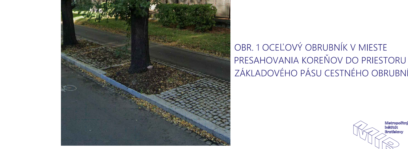
OBR. 1 OCEĽOVÝ OBRUBNÍK V MIESTE PRESAHOVANIA KOREŇOV DO PRIESTORU ZÁKLADOVÉHO PÁSU CESTNÉHO OBRUBNÍKA
