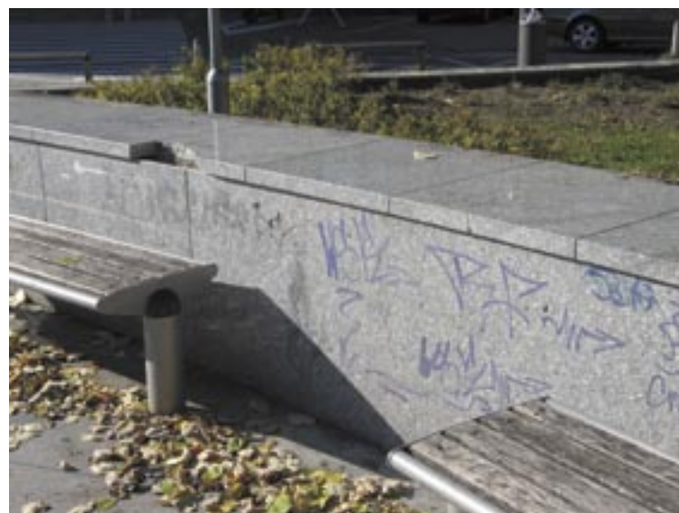
Poškodené lavičky a grafity na Dulovom námestí.
