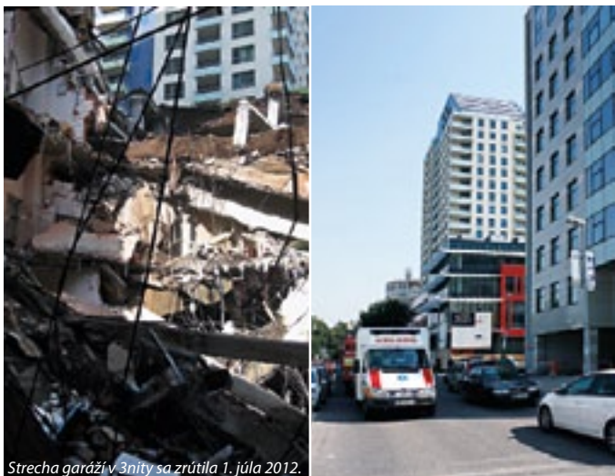
Strecha garáží v 3nity sa zrútila 1. júla 2012.
